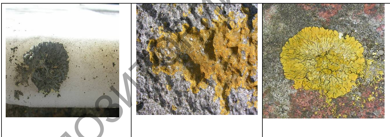
Лішайнікі на белым мармуры, бетоннай паверхні, цэгле
